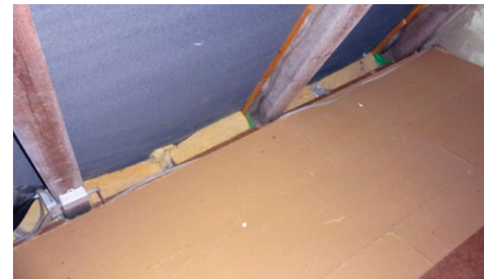
Abb. 51 Holzfaser-Dämmplatten im Dachboden
